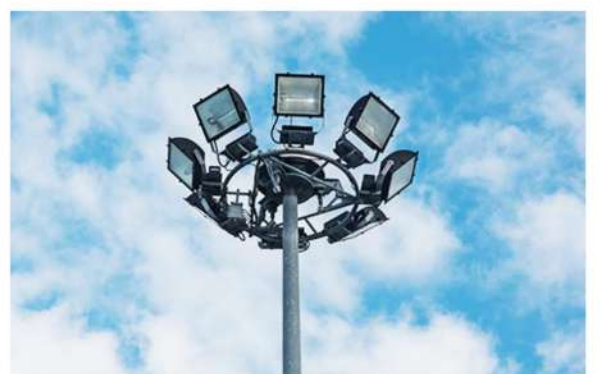
Mini Mast Lighting
